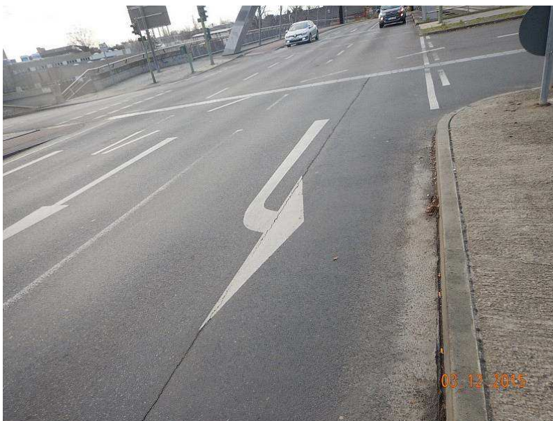
3546231_0_15H_LÄNGSRISS IM BELAG
