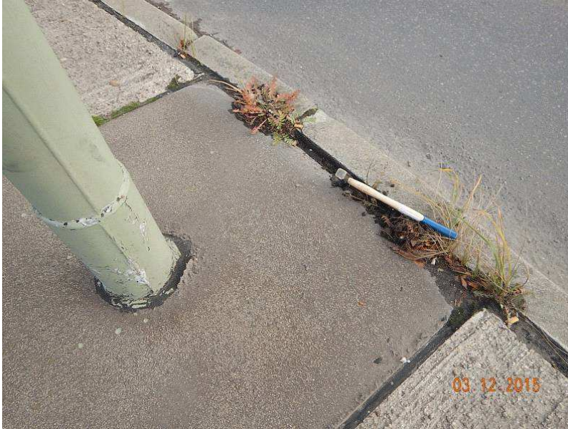
3546231_0_15H_MITTELINSEL FUGE ABGESACKT
