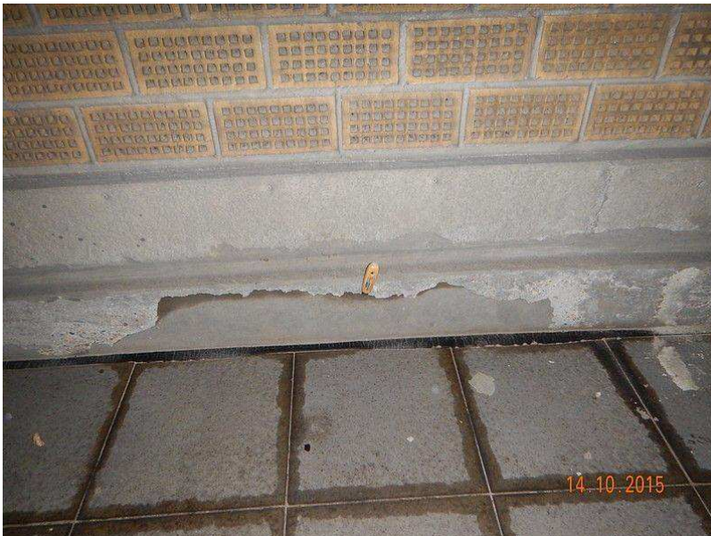
3546231_0_15H BETONABPLATZUNG SOCKEL
