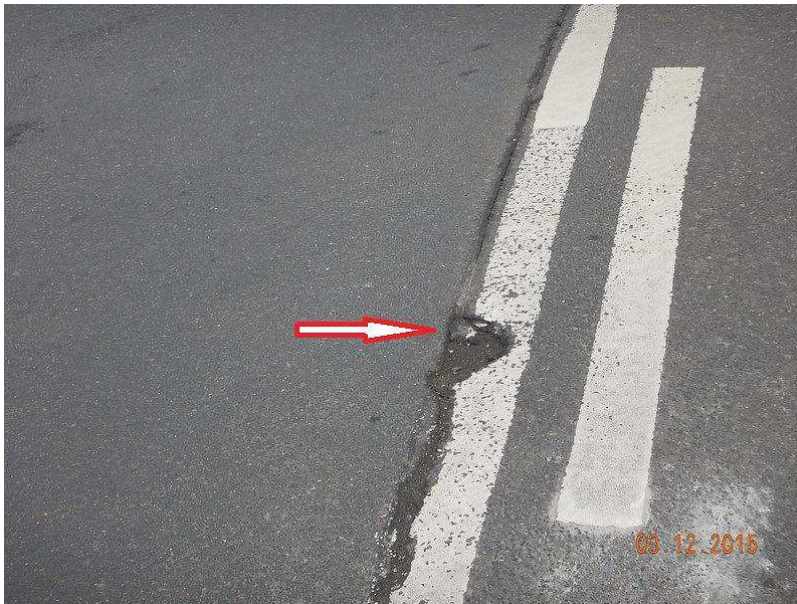
3546231_0_15H_AUSBRUCH IM BELAG
